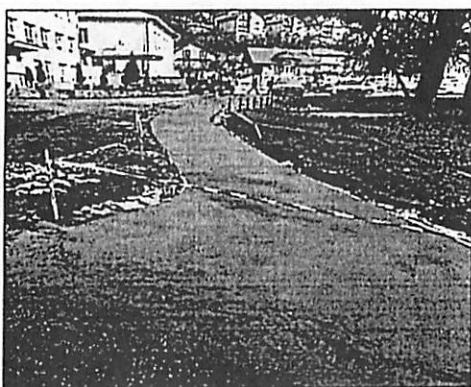
Slika 29. Izrada pješačke staze kod SSŠ (iskop temelja, šalovanje i betoniranje staze, montaža zaštitnih stubića)
